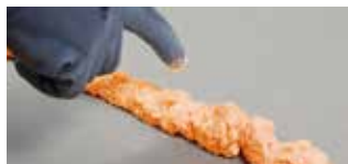
Lijmlaag barst open bij aanraking: te vroeg
